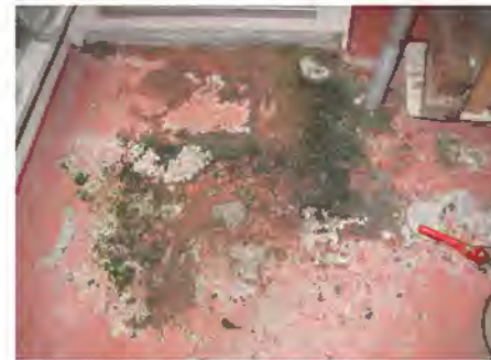
Schimmelvorming door hoge grondwaterstanden
